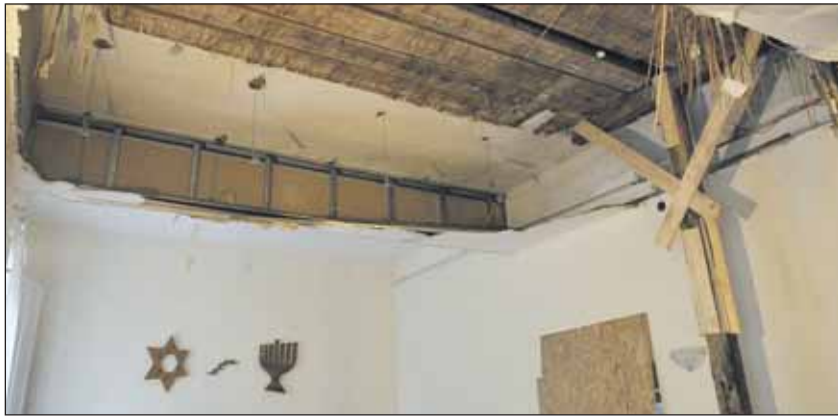
A felújítás során derült ki, hogy az elöregedett födém életveszélyes
