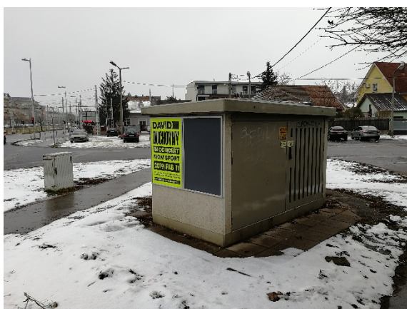
3483 sz. 10/0,4 kV-os betonházas transzformátor
