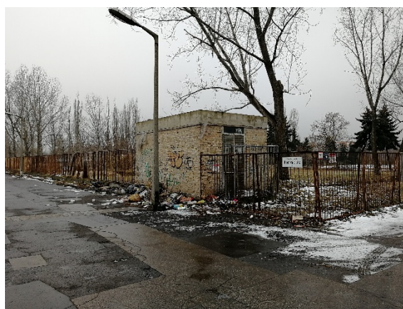
7077 sz. 10/0,4 kV-os építettházas transzformátor
